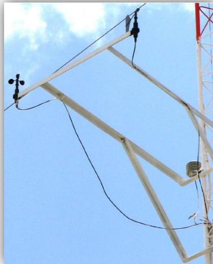
Figura 31. Vista de la estación anemométrica instalada a 30 metros de altura para la evaluación del recurso eólico.
