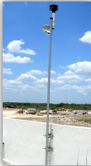
Figura 34. Mini-torre instalada para el arreglo fotovoltaico con los sensores de temperatura ambiente, de velocidad y dirección de viento.
