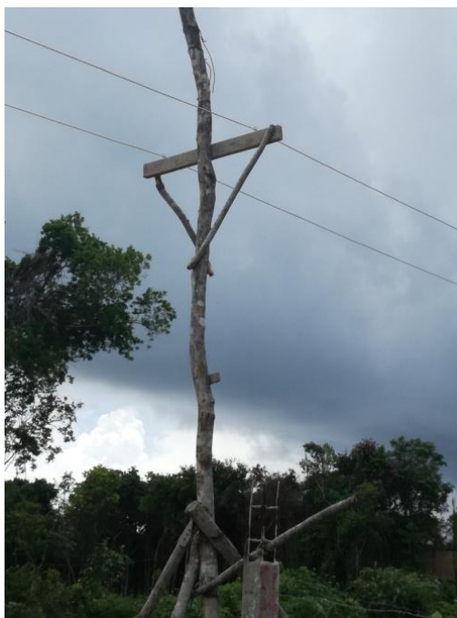
Figura 16. Sistema de electricidad de manera informal del área K
