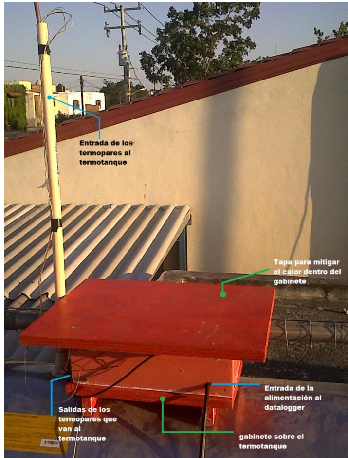
Figura 27. Gabinete del DataLogger
