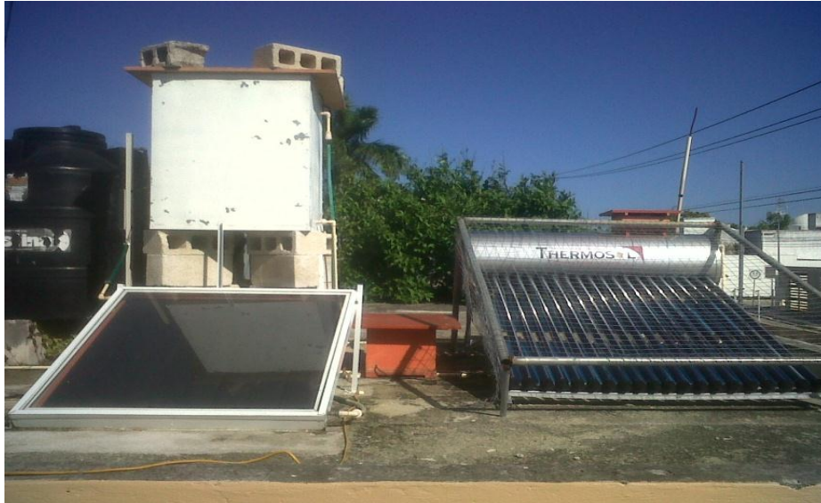
Figura 29. Ubicación final de los calentadores solares y sistemas de monitoreo
