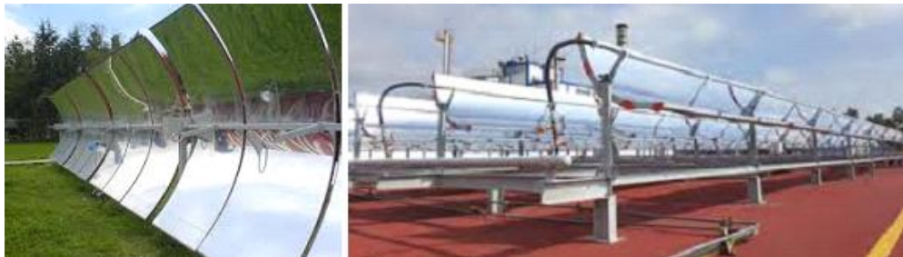
Figura 1.3. Calentadores solares de media temperatura.
