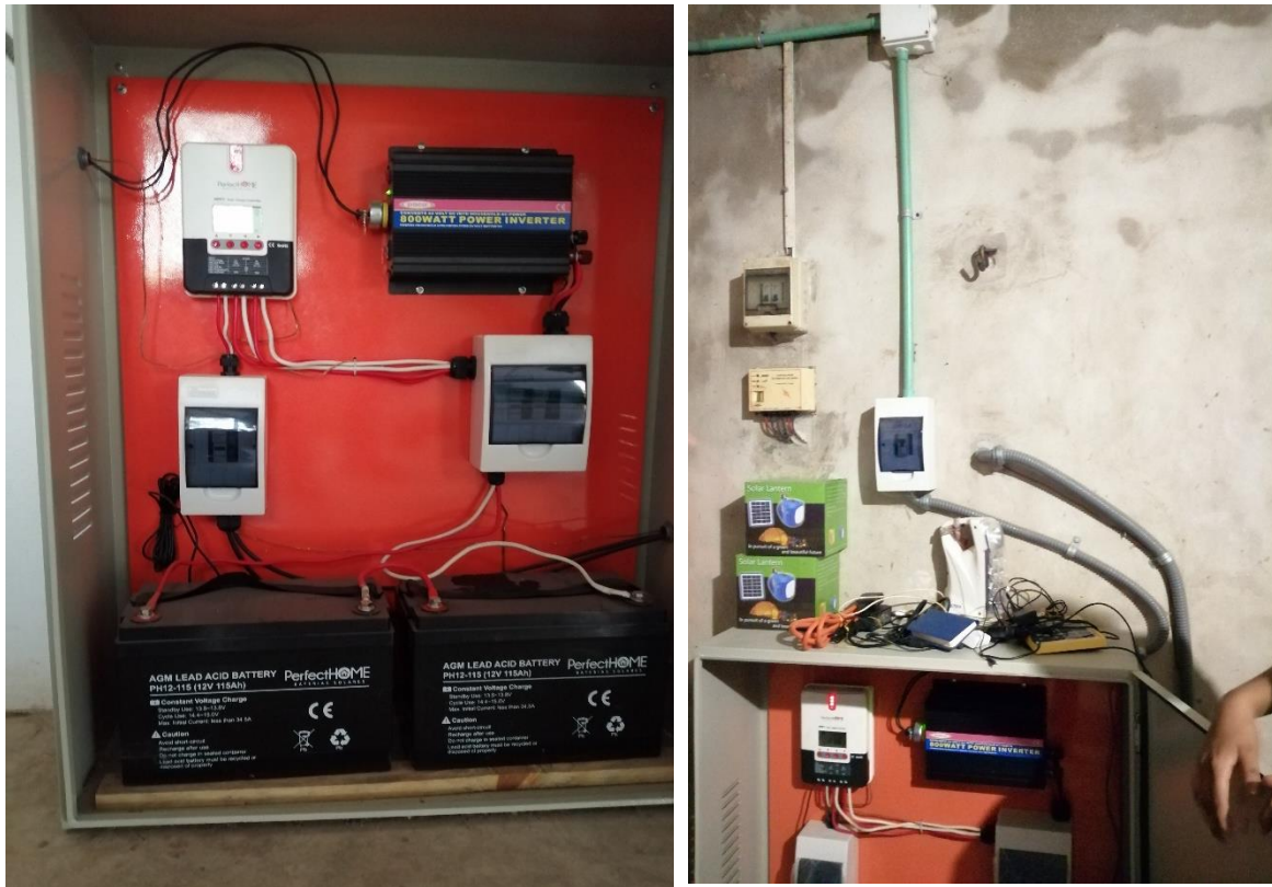
Figura 3.2 Sistema fotovoltaico instalado en Sac-Nicté.
