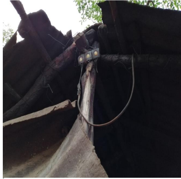
Figura A1.7. Luminarias led improvisadas para iluminar una cocina.
