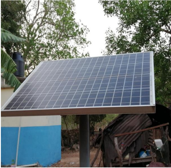
Figura A1.6. Módulo fotovoltaico de 80 W (en funcionamiento).
