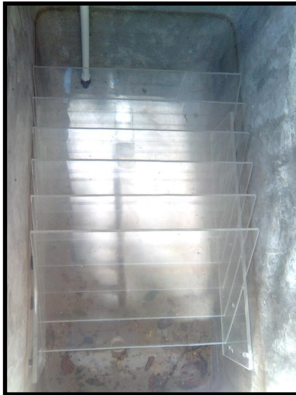
Figura 2.9. SAT instalado en la fosa séptica convencional.
