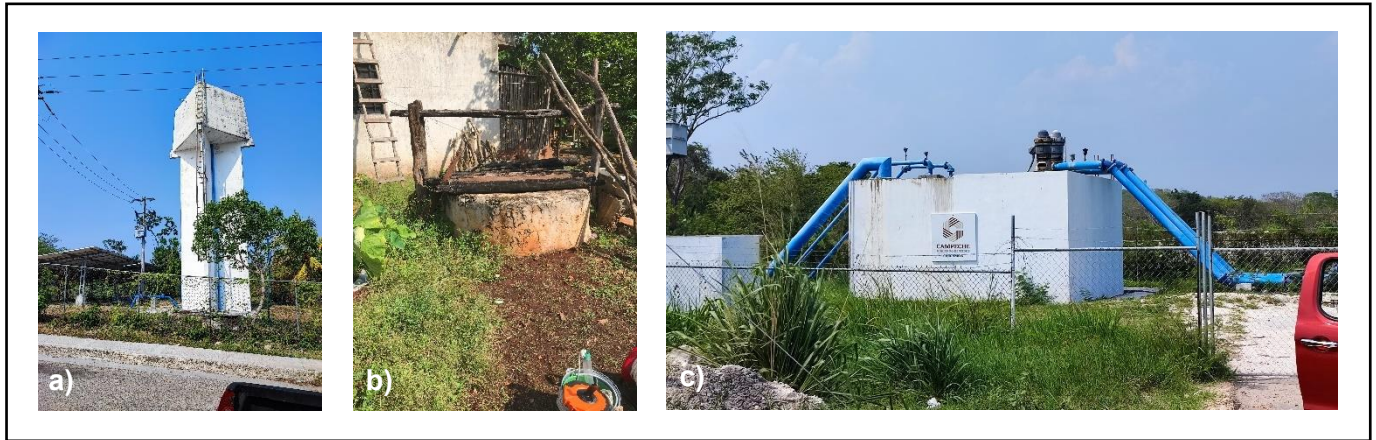
Figura 17. Fuentes de abastecimiento; a) Pozo de distribución en Centenario, b) Pozo artesiano en Yalcobá, c) Cárcamo de bombeo en El Chichonal. Fotografías de Héctor Rumaldo García Castillo.
