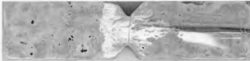
Figura 4.7. Grieta vertical de probeta con fibras de carbón de este estudio.
